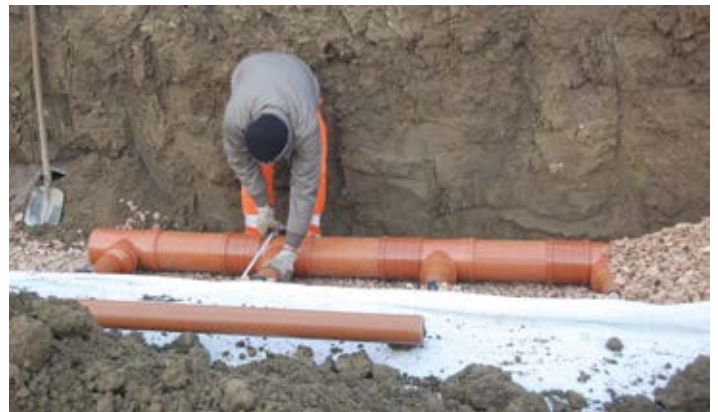
Figura 13 - Collettori per l'alimentazione del Drainpanel
