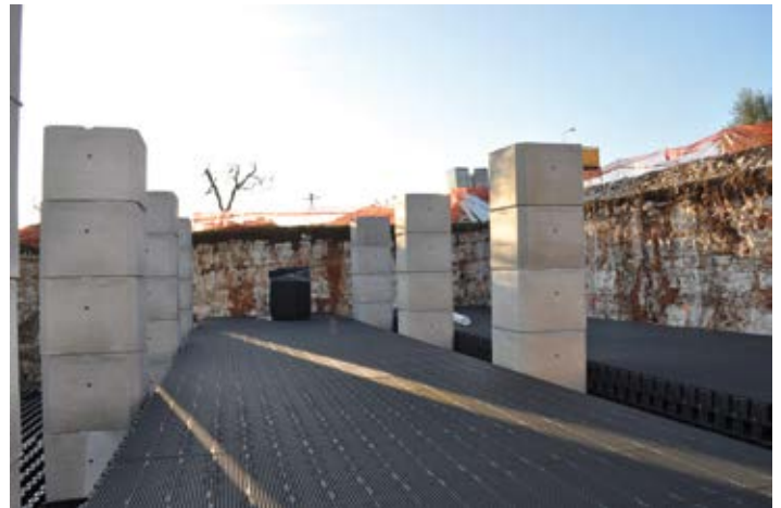
Figura 22 - Pozzetti per operazioni di pulizia bacino
